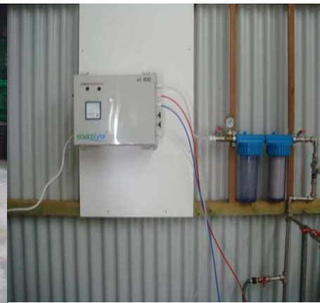
Fig. 7.- Equipo de producción de agua electrolizada.
